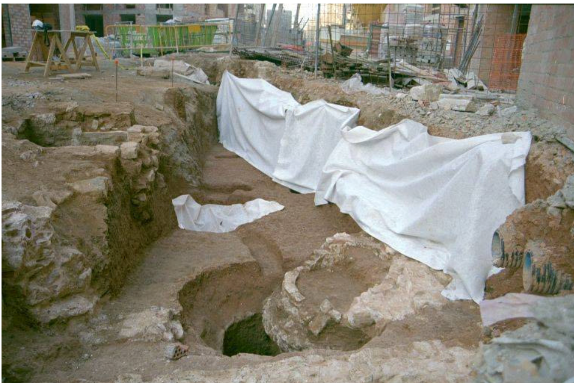
Foto núm.50 Fase I , ramal i dipòsit del Patronat. Protecció amb geotèxtil de les estructures
