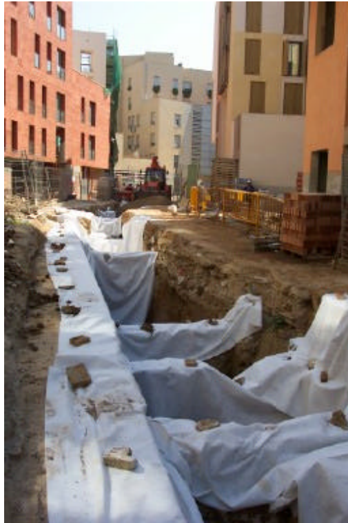
Foto núm.109 Fase II. Protecció amb geotextil de les estructures de la rasa RSU2
