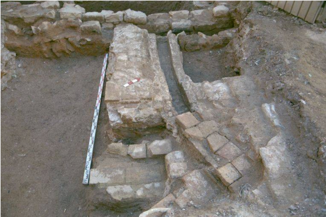
Foto núm.29 Fase I , ampliació RSU1. Claveguera d' època contemporània, UE119 i UE10
